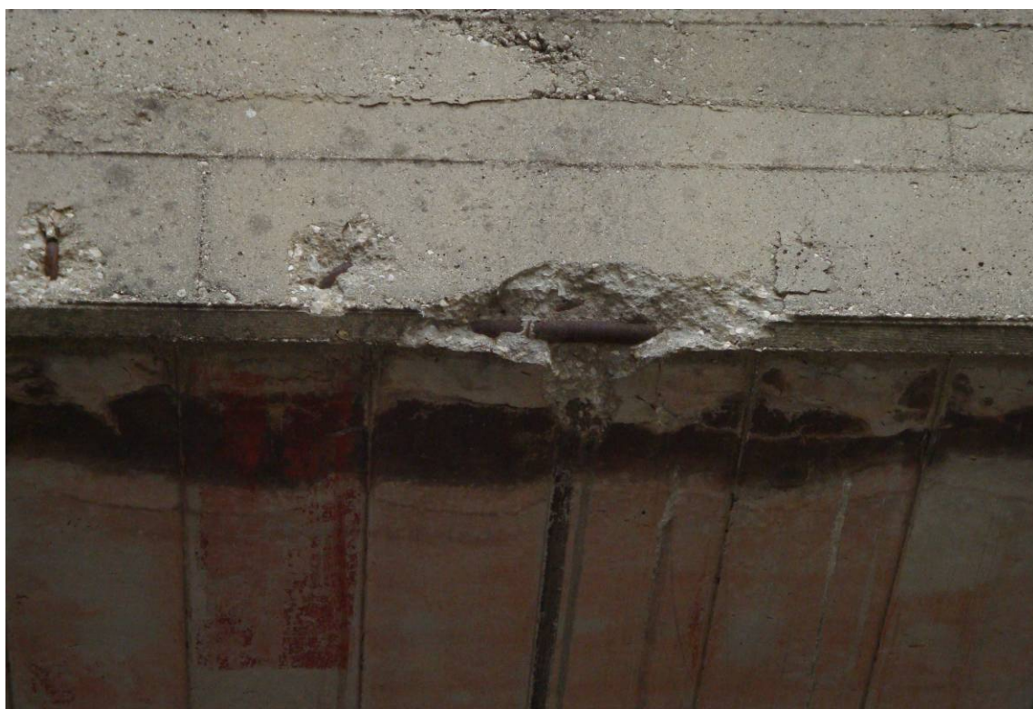
Foto 4 – Intradosso solettone – distacco copriferro (urto)
