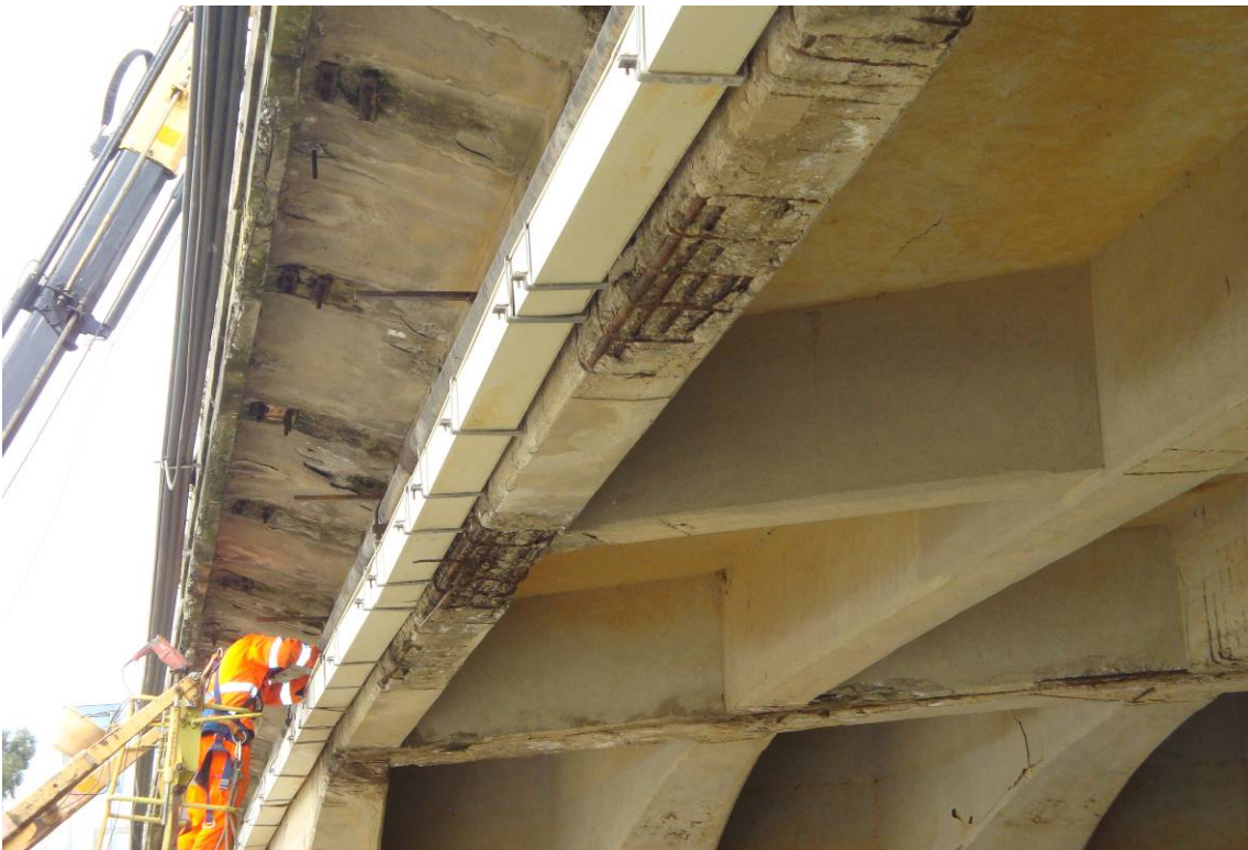
Foto 13 – Vista intradosso impalcato valle – degrado cls.
