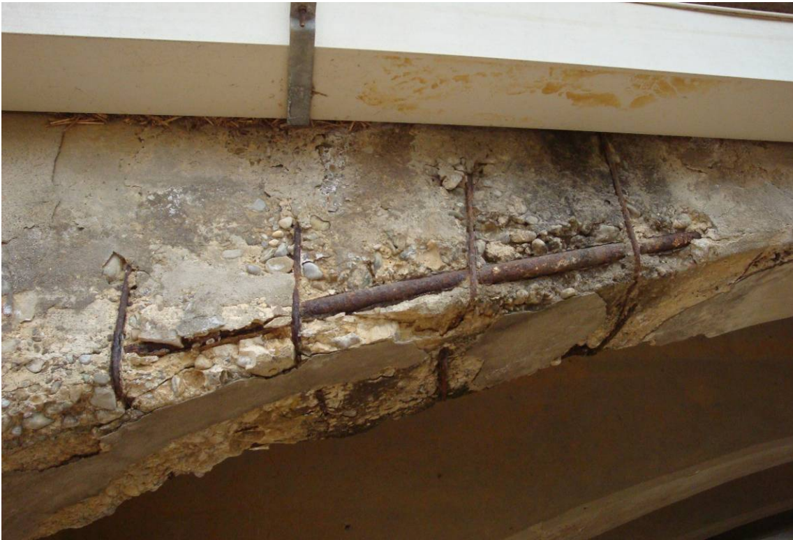
Foto 12 – particolare degrado travata valle
