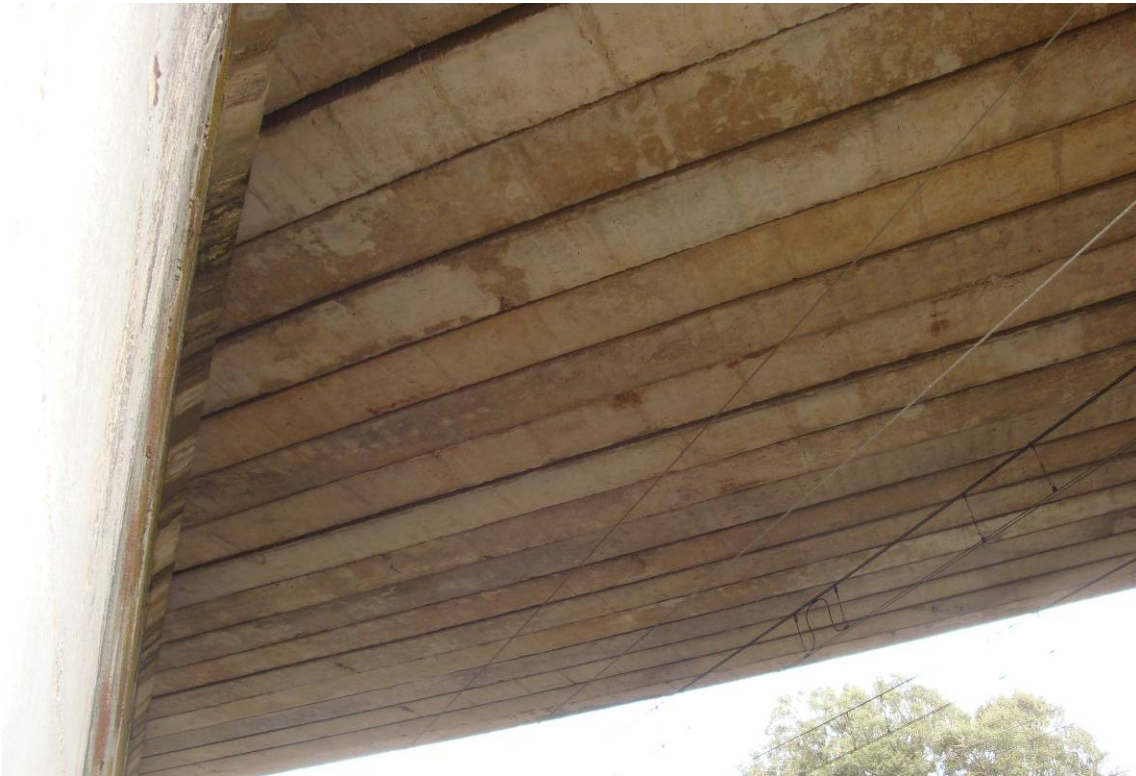
Foto 5 – Intradosso solettone – distacco copriferro
